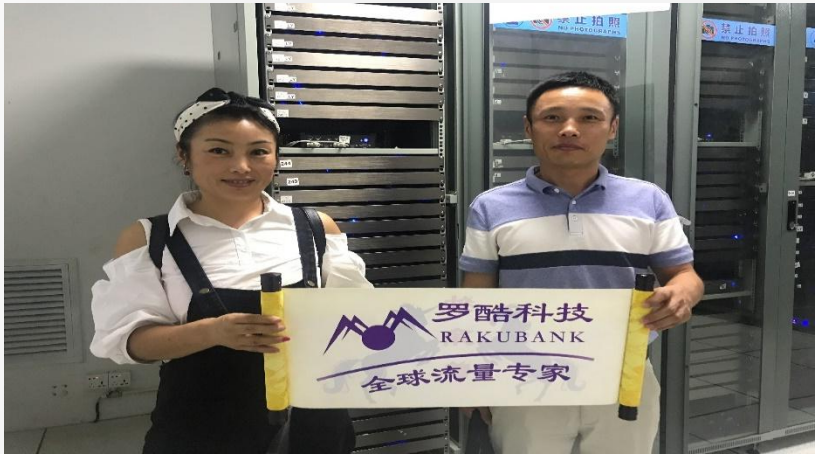
机房环境：网/电/温/湿恒定，实现无人值守
